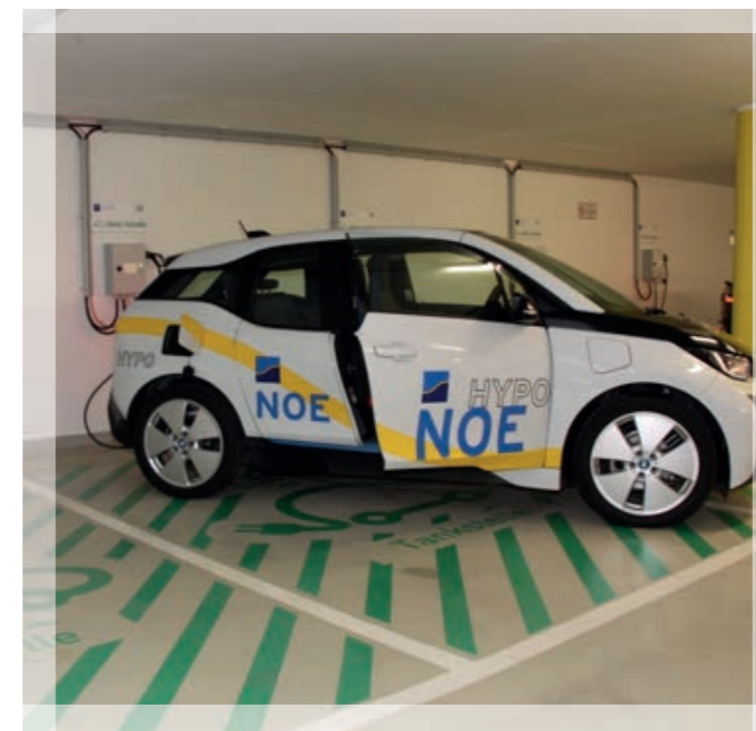
Schnellladestellen und Elektroauto in der Garage der HYPO NOE Landesbankzentrale
